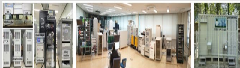
[이차전지 및 250kW/350kWh급 ESS 실증 인프라]
